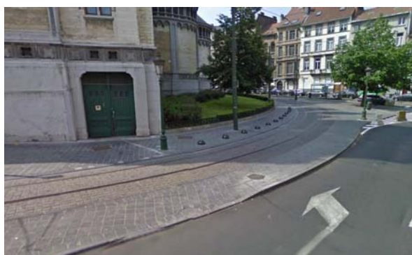
Contournement de l'église Royale Sainte-Marie (pavés glissants et déchaussés + rails de tram en courbe)
